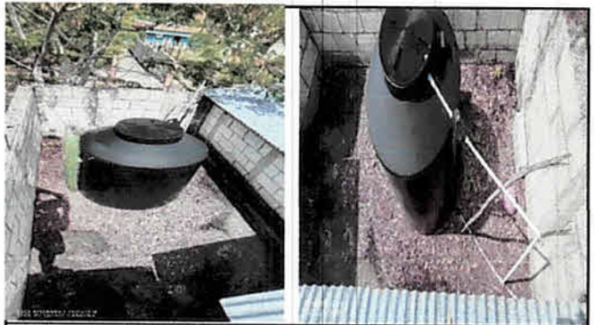
Drenaje para agua pluvial y torta de concreto.
